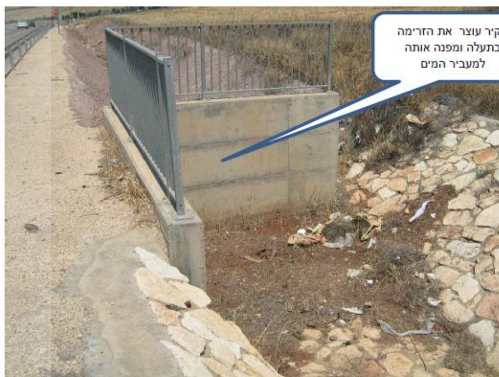
תמונה מס' 4: מתקן כניסה למעביר מים בכביש 768
